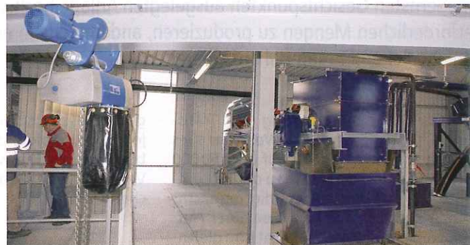
Der Werkneubau weist grosszügige Raumreserven auf, was die Wartung vereinfacht. Absturz-sicherungen, welche den neusten Vorschriften entsprechen, erhöhen die Arbeitssicherheit.
