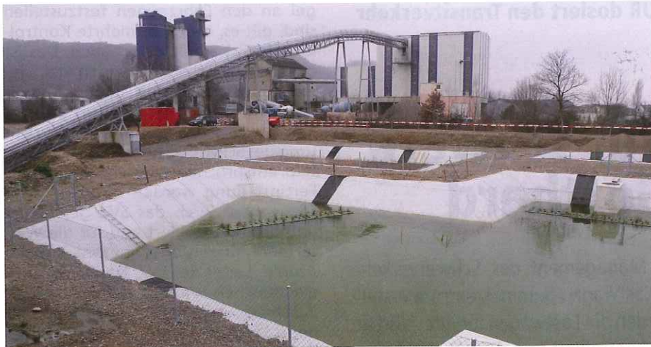
Für das Gesamtareal mit Betonwerk (links) und neuer Kiesaufbereitungsanlage wurde eine Pflanzenkläranlage angelegt. Die Produktion läuft mit einem geschlossenen Wasserkreislauf. (Bild: Spatteneder)
