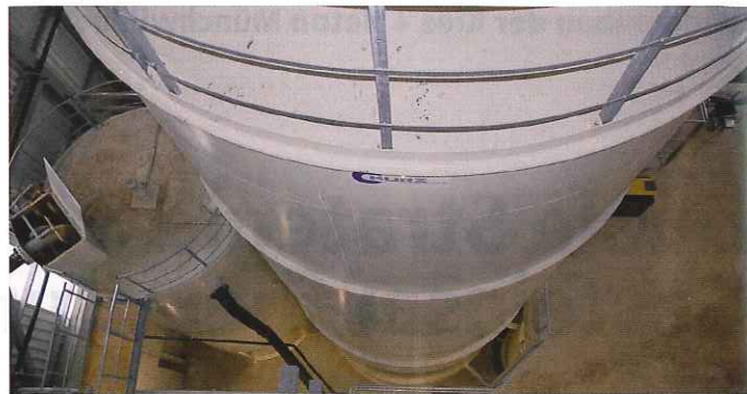
Die Siloanlage mit dem 20 m hohen Schlamm-pufferbehälter von 200 m 3 Kapazität und einem Klärreaktor.
