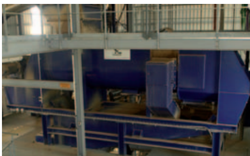
In der Aushubwaschanlage ist es sehr lärmig aber eindrucklich.
